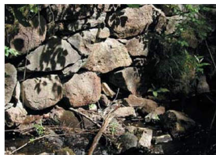
Objekt L: Vassa stenar i ån har rasat och ska läggas tillbaka till muren. Runda stenar tillhör förmodligen åfåran och bör ligga kvar i vattnet.
